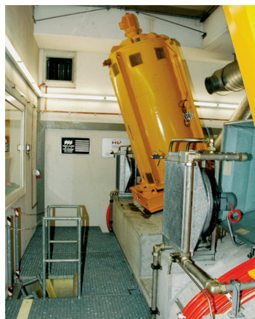
Einer der Generatoren des Kleinwasserkraftwerks. Foto: René Lieb, WBZ
