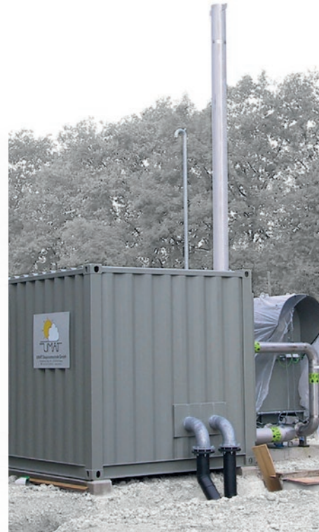
Aufbereitungsanlage für Methangas, das in Kohlendioxid und Wasser gespalten wird. © zvg
