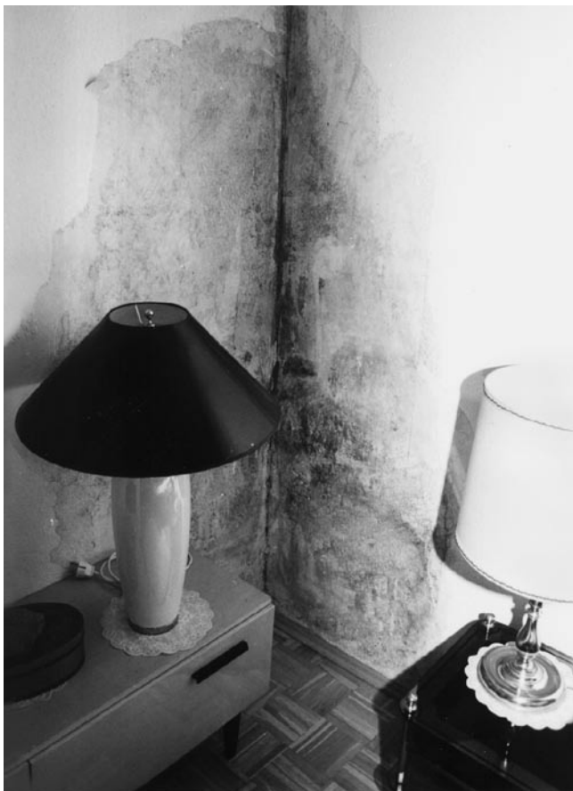
Schimmelpilz in Wohnung. Bild: Institut für Umwelt und Bau- biologie GmbH, D-Velbert
