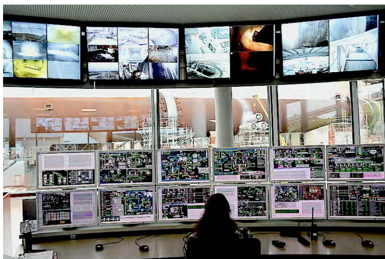
Der Drehrohrofen von Schwenk Zement in Allmendinger (D), aufgenommen aus der Kommandozone. Foto: AefU
