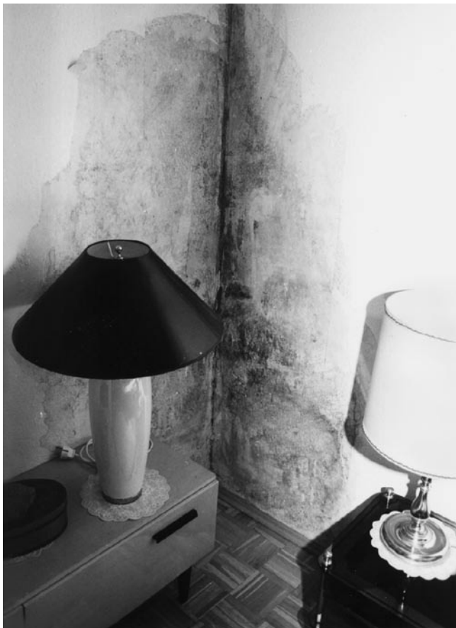
Schimmelpilz in Wohnung. Bild: Institut für Umwelt und Bau- biologie GmbH, D-Velbert
