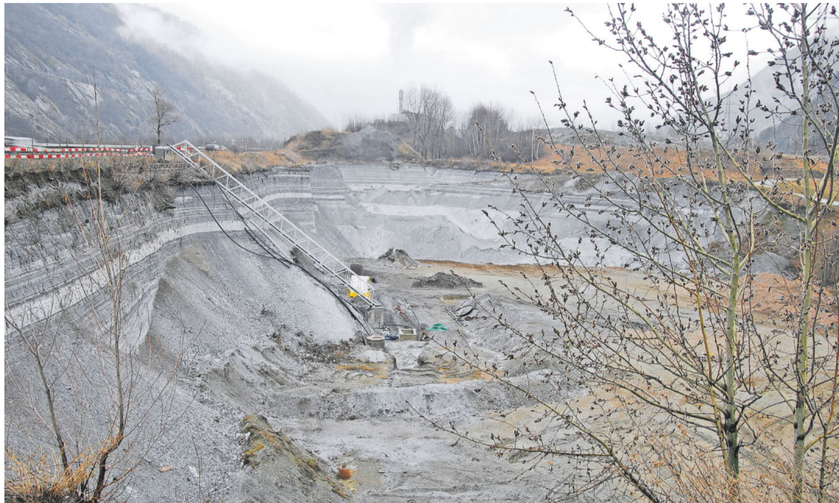
Kontaminiert. Das abgepumpte und behandelte Grundwasser enthält neben Quecksilber auch Ammonium und verschiedene organische Schadstoffe in relevanten Konzentrationen. Die Liste der zu überwachenden Schadstoffe wurde aufgrund der neuen Screening-Analysen, welche die DUS verlangt, erweitert. FOTO WB
