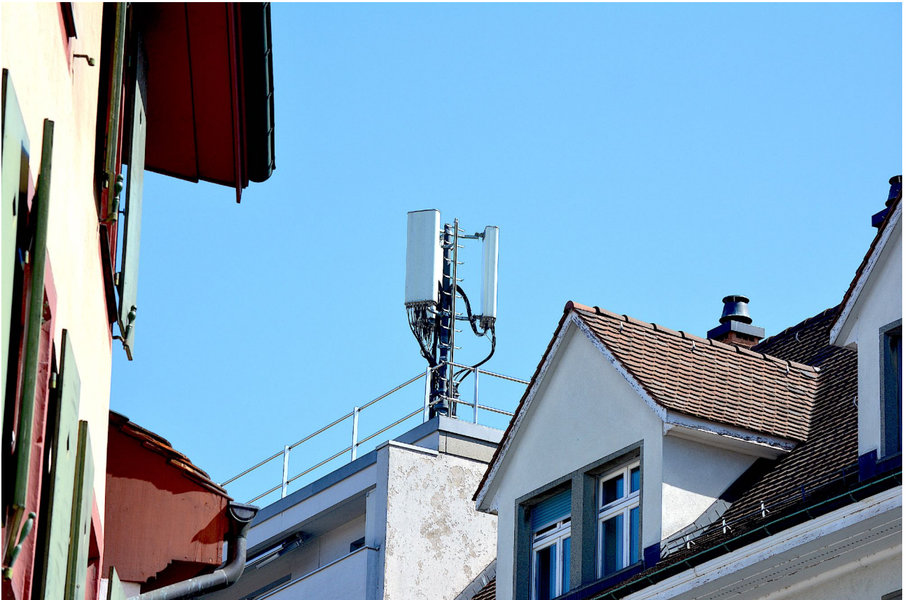
Mobilfunkmast in der Webergasse in Basel. Foto: AefU
